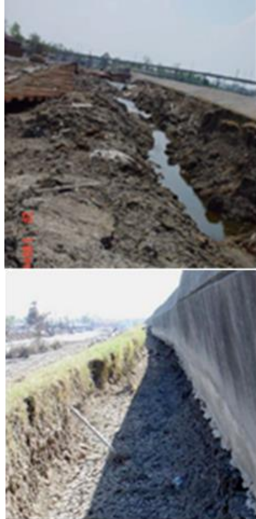
Figura 5. Exceso de erosión en la grieta sur y una sección cercana intacta.
